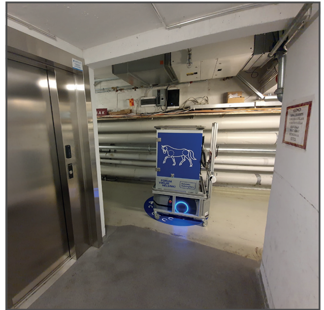
Porusza się niezależnie wzdłuż tunelu serwisowego, wind i ramp w Kustaankartano.
